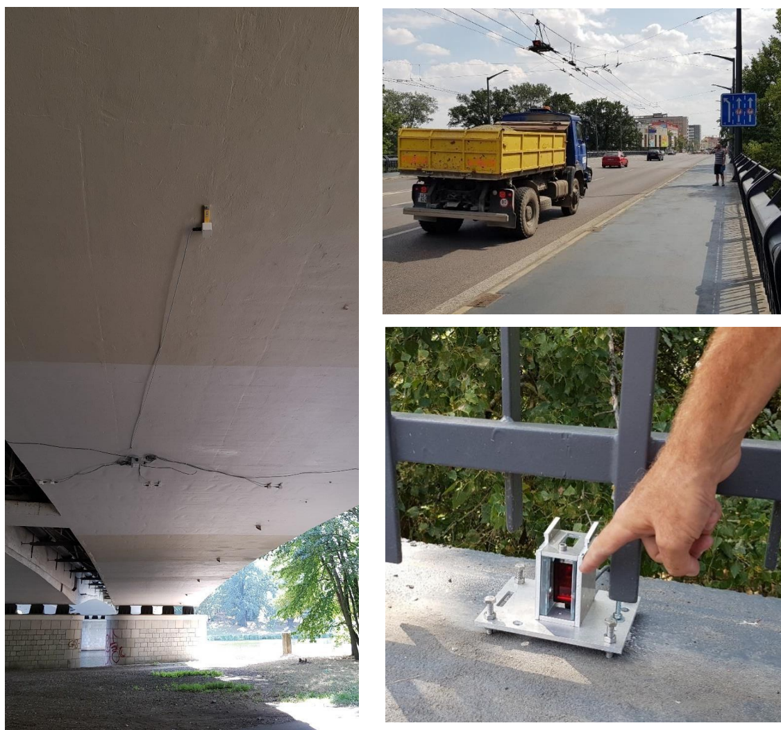
Obr. 3. Pohled na typickou instalaci systému iBWIM na zkoumané mostní konstrukci (vlevo), přejezd nákladního vozu pro kalibraci systému (vpravo nahoře), laserový snímač pro detekci přejezdu vozidel a identifikaci počtu náprav (vlevo dole).
